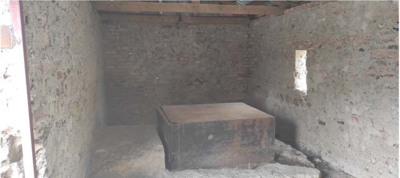
Рисунок 6 - Защитный кожух, установленный вместо вала и редуктора первого водяного колеса (фото автора, дата съемки 05.05.2022).
