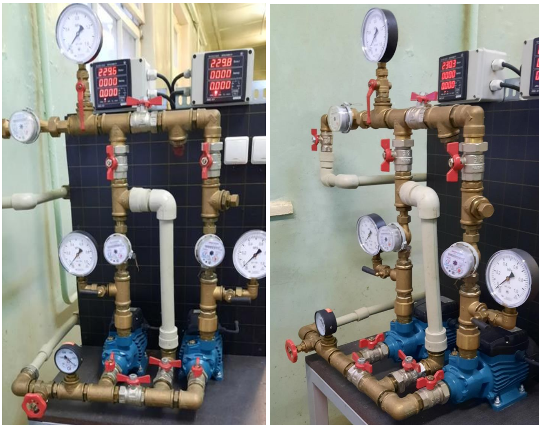
Рисунок 2 – Фотографии лабораторной установки для исследования работы вихревых насосов
