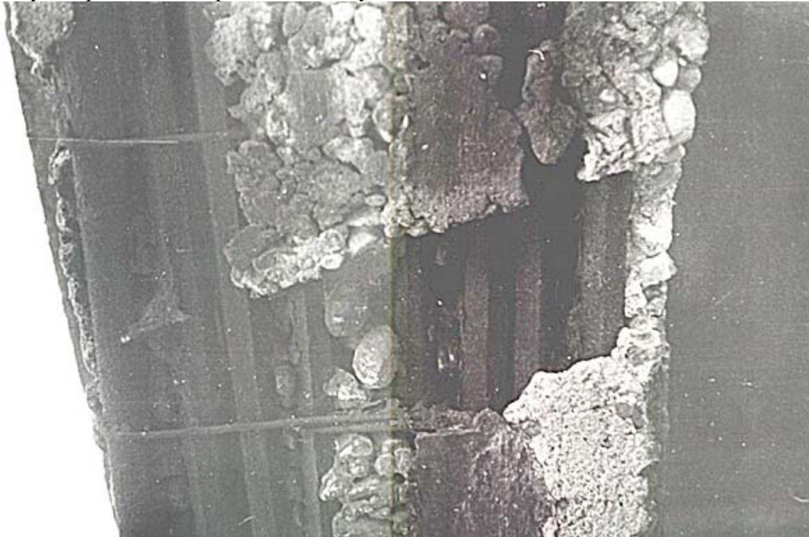
Рисунок 3 – Колонна верхнего яруса трибун стадиона «Измайлово» до ремонта
