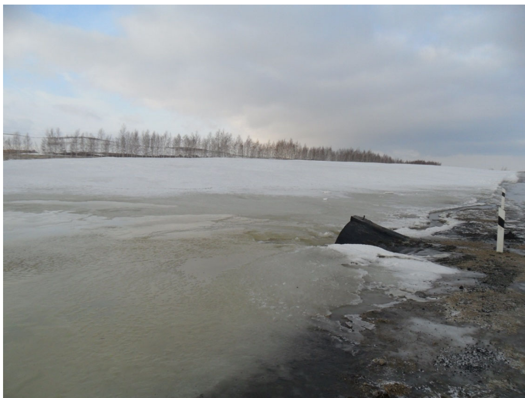
Рисунок 1 – Образование наледи в водопропускной трубе и на подходе к ней
